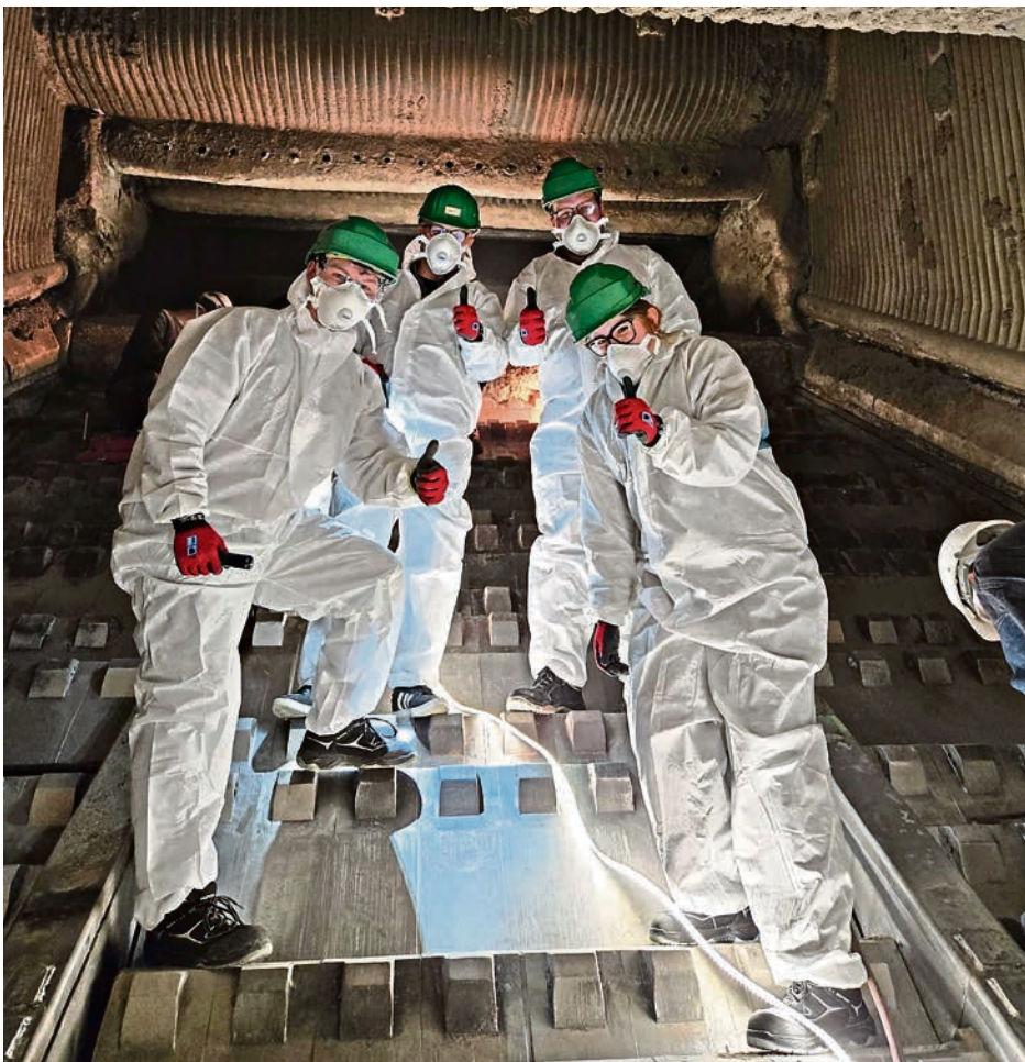
Das Herz der MVA Ingolstadt – Checkup im Inneren einer der drei Verbrennungsöfen
