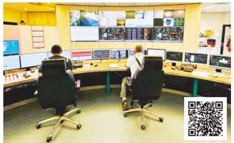
Im Herzstück der MVA – die Messwerte überwachen die Mitarbeiter den reibungslosen Ablauf aller Vorgänge in der hochtechnisch ausgerüsteten Anlage
